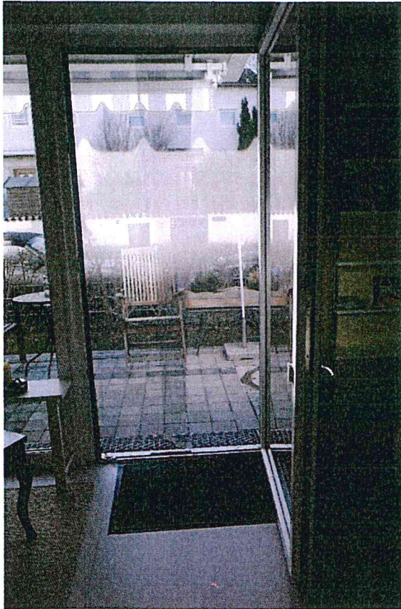
Abb. 2 Schwelle Terrassentüre Wohnzimmer
