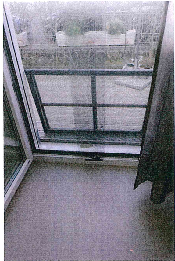
Abb. 3 Schwelle Terrassentüre Schlafzimmer
