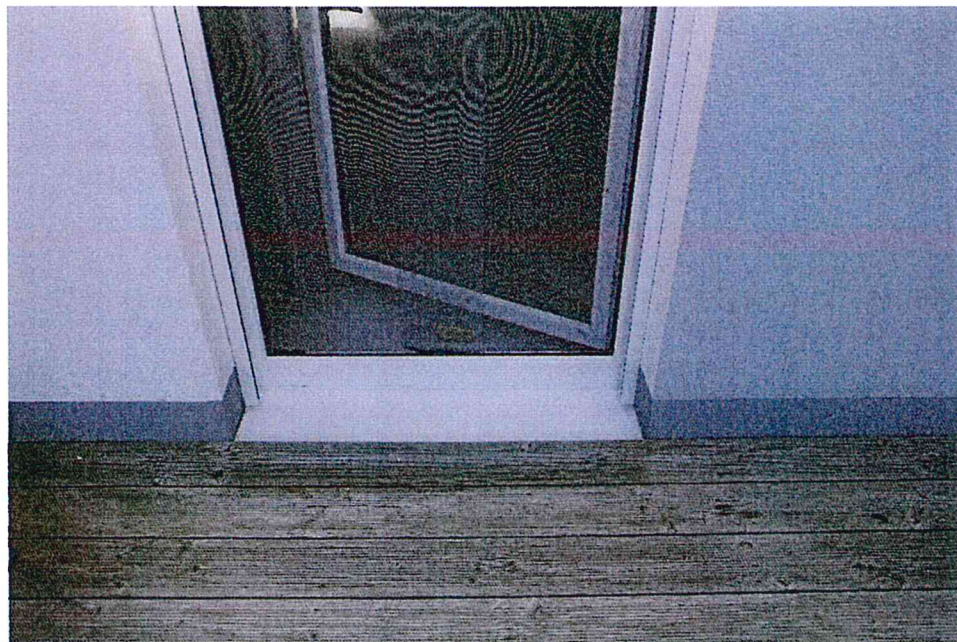
Abb. 4 Bodenblech bei Terrassentüre Schlafzimmer
