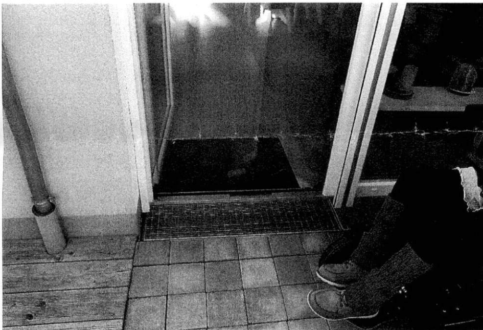
Abb.1 Fläche vor dem Terrassenausgang Wohnzimmer
